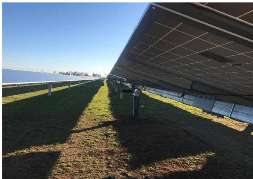
Figura 2: Esempio di impianto fotovoltaico realizzato con supporti costituiti da pali in acciaio infissi direttamente nel terreno. Gli impatti sul suolo sottostante risultano essere minimizzati.
