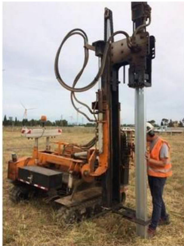
Figura 1: Esempio di supporto costituito da palo in acciaio infisso direttamente nel terreno mediante battipalo.
